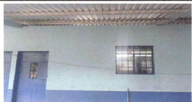
Foto 4: En la vista se observa la colocacion de ventanas transparentes del Instituto.
